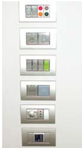
Εικόνα 31. Ο πίνακας ελέγχου στο εσωτερικό ενός εργασιακού χώρου laser-PCL.
