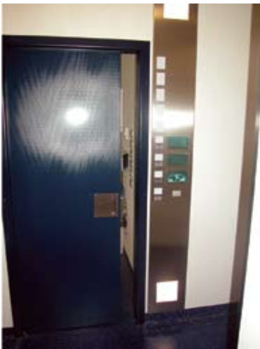
Εικόνα 30. Μαγνητικό σύστημα κλειδώματος της πόρτας προκειμένου να είναι ασφαλής ο χώρος λειτουργίας του laser.
